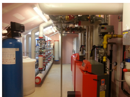
Chaufferie avec géothermie pour la MRS d'Amonines
